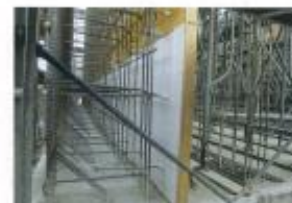
型枠の表面には透水シートを張り付けて、フリーディングによる美観低下を防ぐ(写真:井口建設工業)
