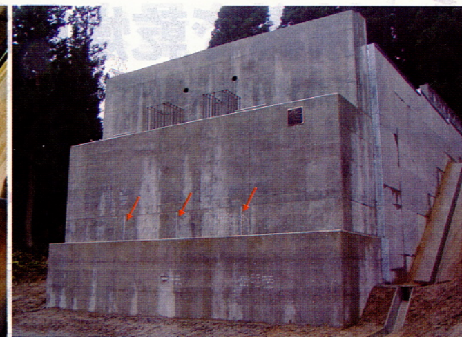
左:先行壁体部に設けた収縮低減目地。市販品のひび割れ誘発目地をそのまま使える 右:国土交通省北陸地方整備局が発注した橋台工事。矢印の部分が収縮低減目地。井口建設工業(新潟県南魚沼市)が施工(写真:井口建設工業)
