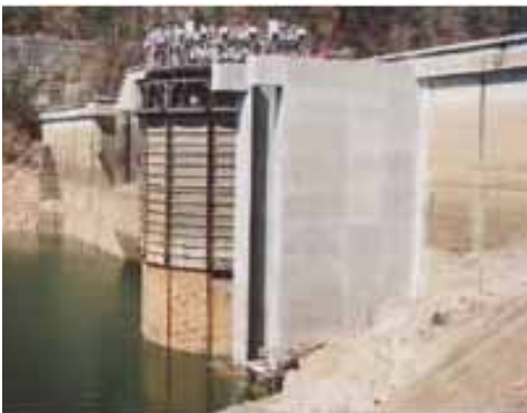
(a) 水力発電所の選択取水設備
