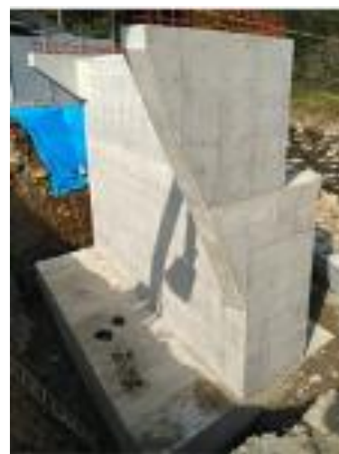
三重県発注 一般国道368号(上長瀬)道路改良(2号線下部工)工事
