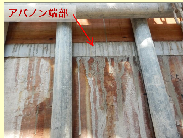
アバノン上端部(外部)からの排水状況
